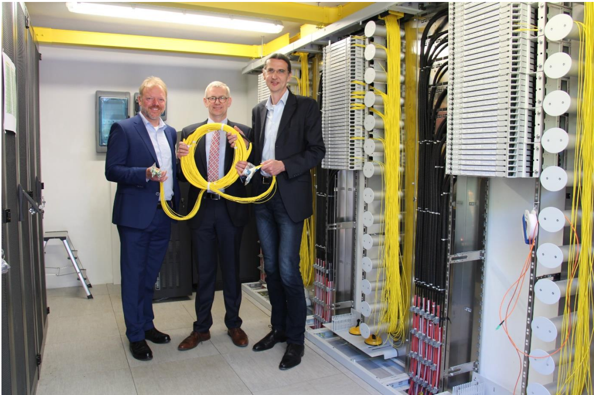
Peer Beyersdorff, Dr. Heiko Blume und Norbert Hill in der Verteilerstation
